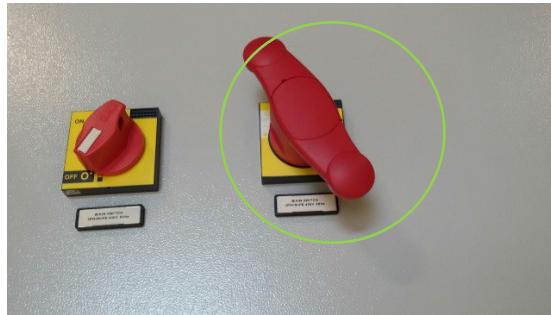
Interruttore generale quadro calorimetro
